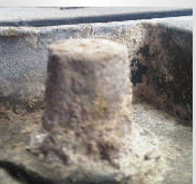
SULFATADO Ocasionado por un golpe.
