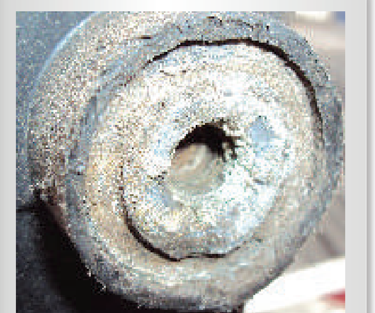
DAÑADA Por golpes o falso contacto en la conexión.
