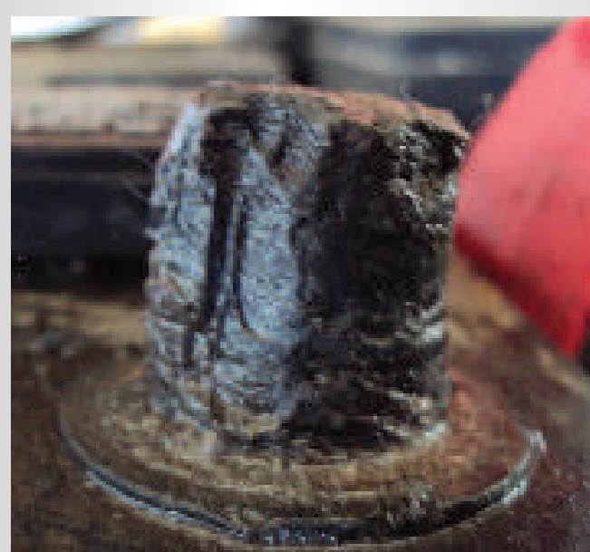
EXCESO DE SUJECIÓN Por terminales demasiado apretadas.
