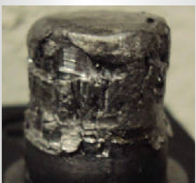
APRETADO Por utilizar terminales inadecuadas o usar terminal negativa en poste positivo.
