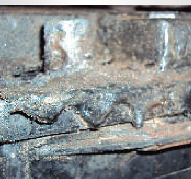
QUEMADA Por exceso de calentamiento en el motor.
