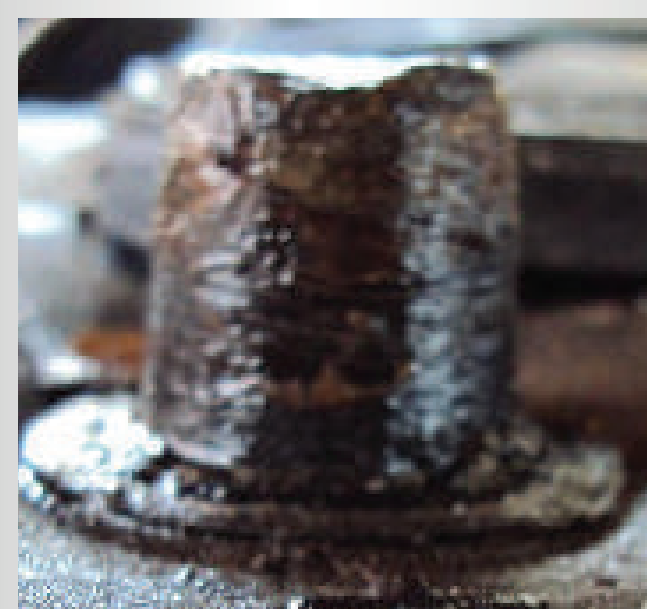
HUNDIDO Por golpes directos al poste o tornillo.
