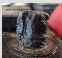
EXCESO DE SUJECIÓN Por terminales demasiado apretadas.
